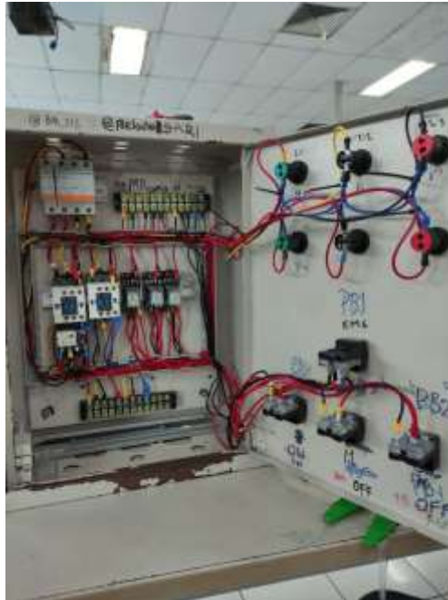
Gambar 3. Gambar Sistem Kendali Motor 3 Fasa yang Telah Direalisasikan
